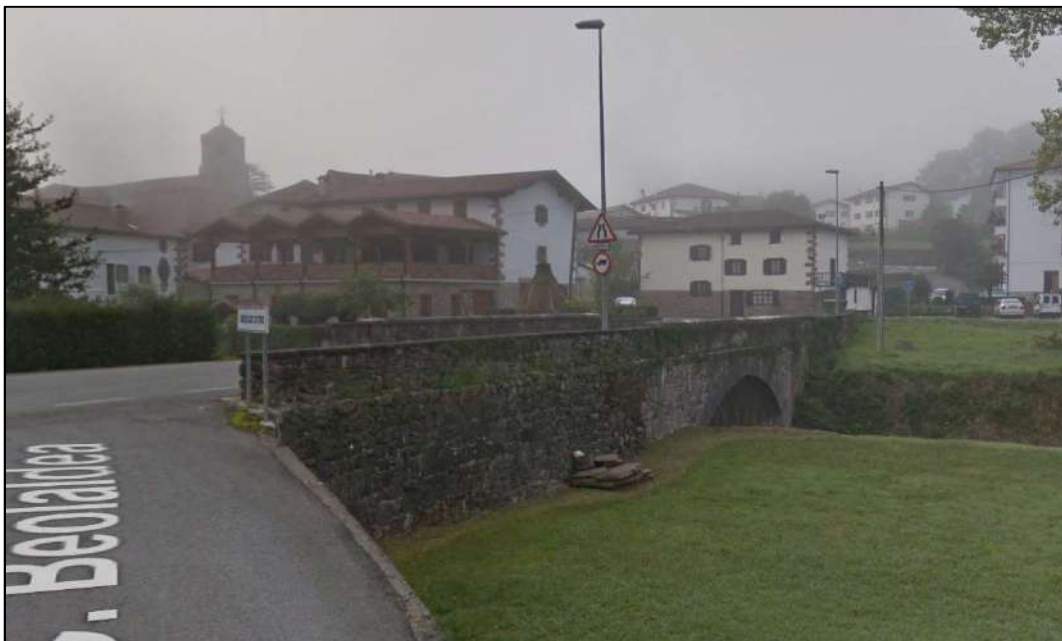
Figura 22. En la imagen superior se muestra una fotografía tomada durante la visita de campo, del puente de la carretera NA-4400 sobre el río Tximista, en la entrada al barrio de Antsolokueta. Por esta carretera se accede hacia el puerto de Lizarrieta. Este puente es el señalado con el numero [4]. Por su parte, en la imagen inferior se muestra una captura de pantalla, obtenida de GoogleMaps, del puente, también de la carretera NA-4400, pero en este caso se trata del puente que se encuentra más aguas abajo en el acceso al casco urbano de Etxalar. Se trata del puente [5].
