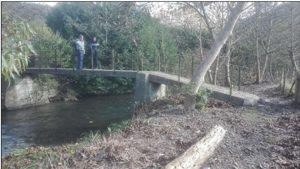
Figura 40. Fotografías tomadas en la zona del puente peatonal sobre el Tximista en la zona de Antsolokueta, aguas arriba de la presa. En estas fotografías se ilustra el aspecto que ofrece el margen izquierdo del río Tximista en esta zona. Es por estas zonas por las que se extiende la inundación en la localidad.
